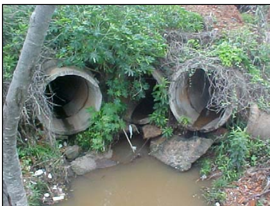
Foto 22 – Lançamento das águas pluviais sem um sistema adequado de dissipação de energia, no afluente da margem esquerda do córrego do Botafogo (Unidade Ambiental IV).
